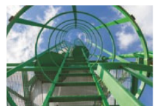
Recubrimientos de pintura en estructuras de acero
